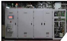
▲ DC ESS용 1MW
